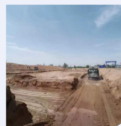
▲ 7月1日，蒙发农牧业公司蒙发田园综合体项目一期工程开工挖槽。
